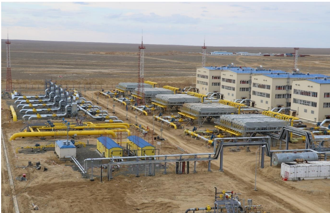
1.2 Сурет – «Бозой» компрессорлық станциясы (бұдан әрі – КС)
